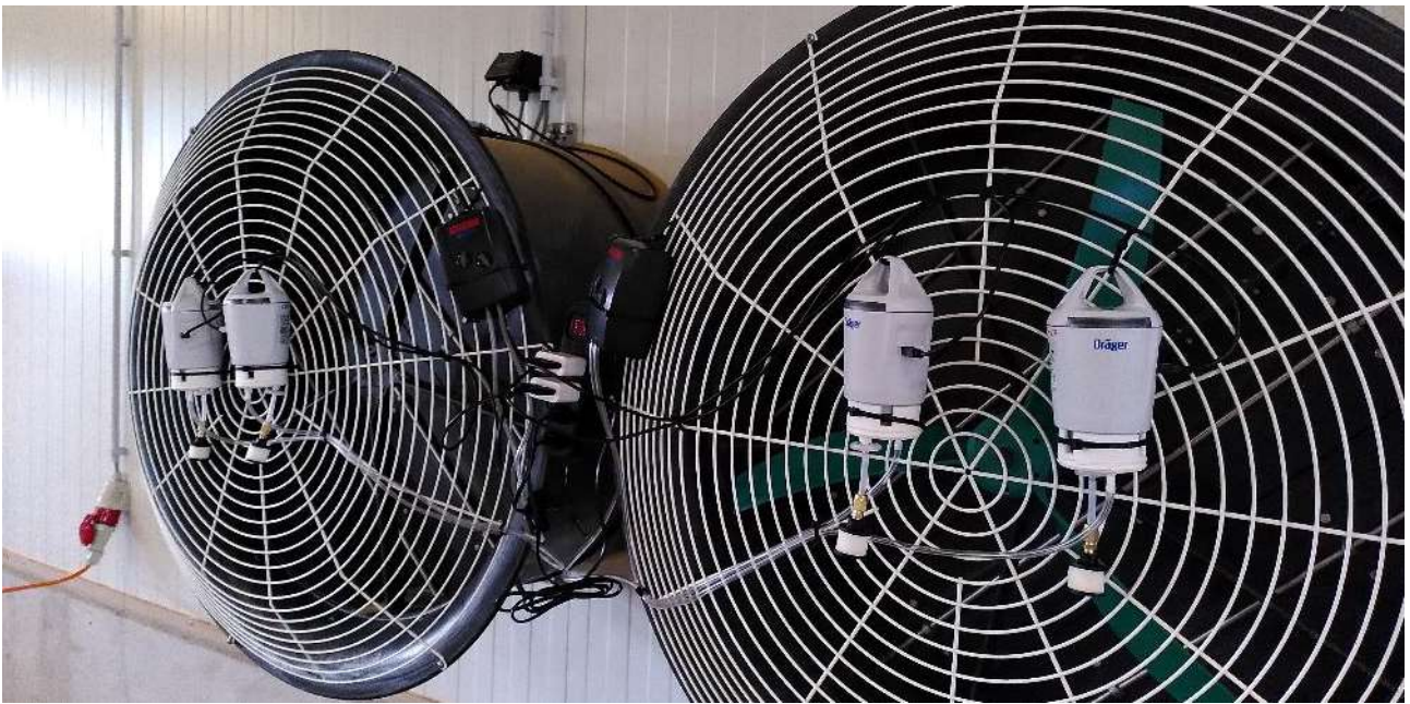
Abbildung 8: Messeinrichtungen bei zwei Abluftöffnungen: Messventilatoren zur Messung der Luftaustauschrate und je ein Sensor für die Messung der Konzentrationen von \text{NH}_3 und \text{CO}_2 . Jede der 3 bzw. 4 Abluftöffnungen der Ställe (Abbildung 7) war ausgerüstet wie hier abgebildet. Zusätzlich wurden die \text{NH}_3 und \text{CO}_2 Konzentrationen bei jeder Zuluftöffnung gemessen.
